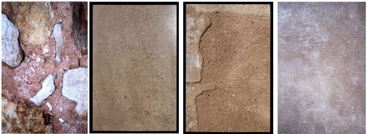
Figure 37 - Zoom sur des enduits de plâtre
