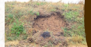
Erosion du talus due au manque de végétation pour retenir la terre.
